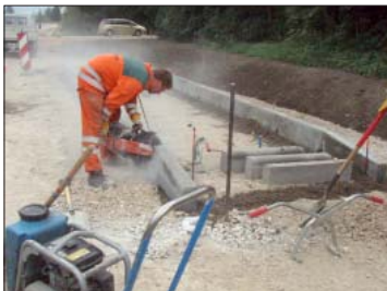
Betona griešanas laikā putekļu koncentrācija var pārsniegt pieļaujamo pat 10–30 reizes.
